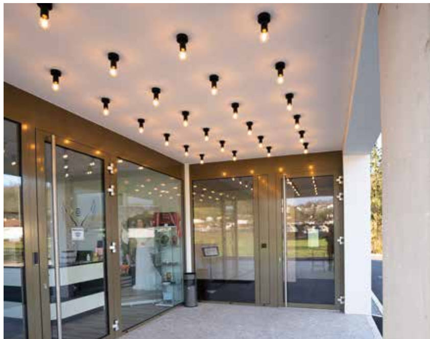
Der Eingangsbereich zum Motel, in dem derzeit unter anderem die Beleuchtung, Beschaltung und Bewegungsmelder in den Gängen gesteuert werden
