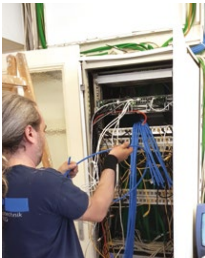
Bei diesem Kabelsalat fiel der Überblick schwer
